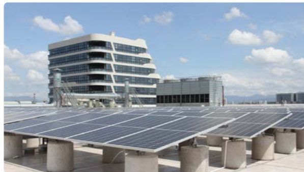
○ 上海建发物流中心 1 MW 分布式光伏发电项目， 预计年发电量 110 万度
