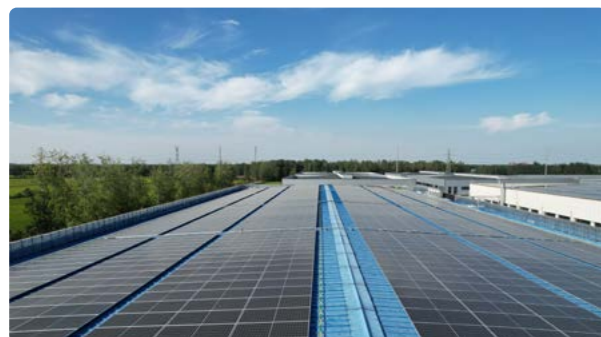
○ 世恒医疗 1.1 MW 分布式光伏发电项目， 预计年发电量 120 万度
